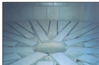
Fondo de silo de 30'-0" pies de diámetro, totalmente aireado, usando canales de ventilación.
