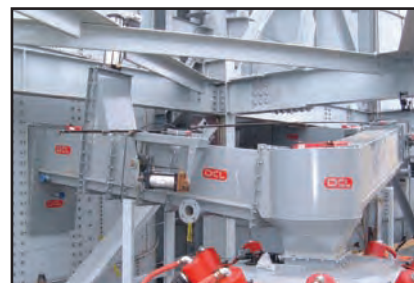
Adaptador de penetración con válvulas de control de flujo alimentando la estación de carga.
