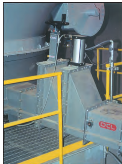
Válvula vertical manual y válvula deslizante neumática.
