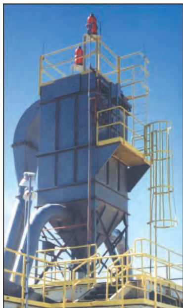
Colector de polvo con plataforma de acceso y riel de seguridad.
