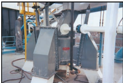
Caja de distribución aireada, con cuatro descargas.
