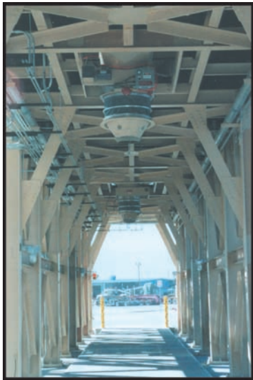
Estación de carga equipada con dos mangas y sus posicionadores.
