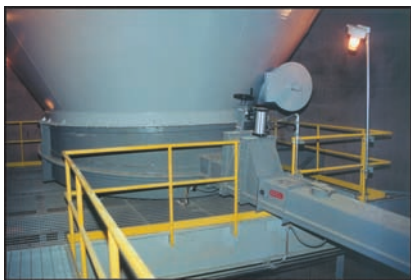
Fondo aireado, descargando en un transportador con válvulas deslizantes.
