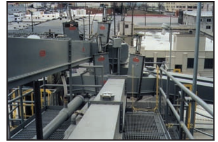
Aerodeslizadores distribuyendo a varios silos, utilizando la combinación de cajas de volteo y compuertas deslizantes verticales.
